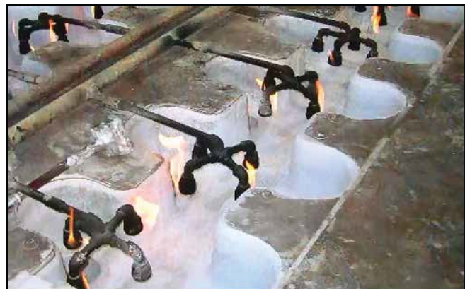
PRECALENTADORES CON ALIMENTADORES CRUZADOS SUMINISTRADOS POR EL PROVEEDOR
